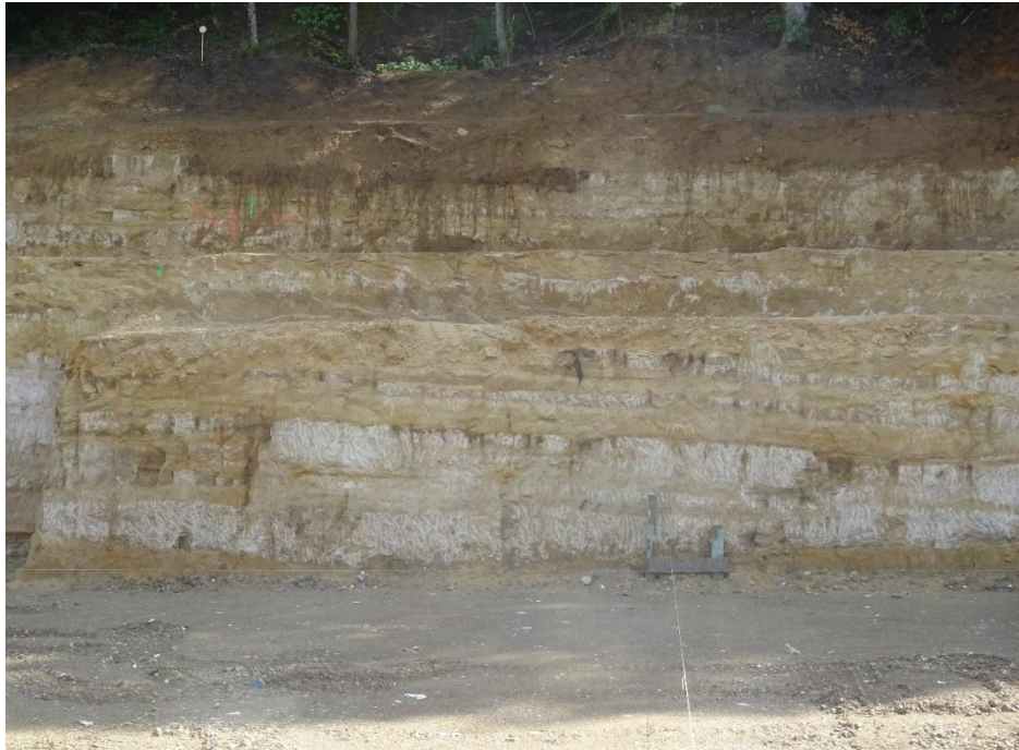
Abbildung 7: Hangabbau an der Rue de Steinfort zum Bau von Wohnhäusern, Quelle: eigene Aufnahme, Juli 2018
